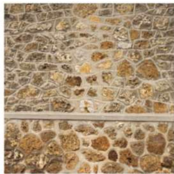
assemblages des pierres meulières et bandeau en béton état apparent : ++
